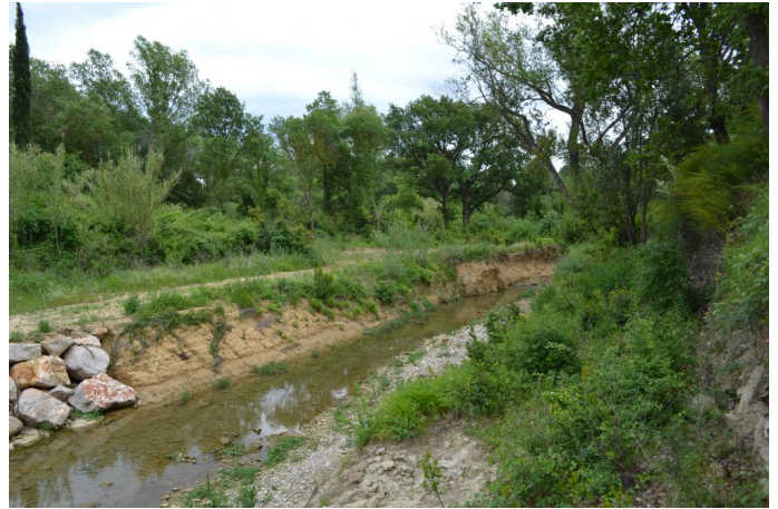
Berges érodées en amont du Mas de Bussac, le 03/05/2017 par Jérémy Cuvelier.
